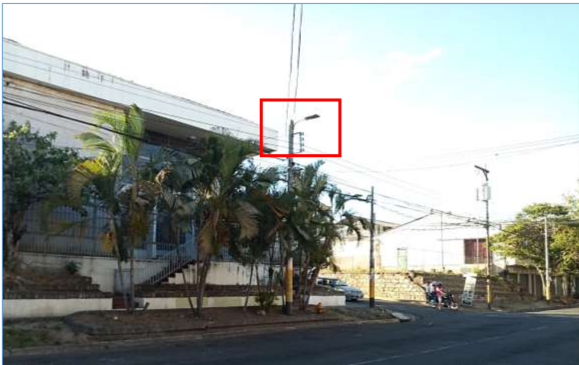
Figura 71. Luminaria a lo largo de la Calle Real Fuente: Fotografía propia. Febrero de 2020.
