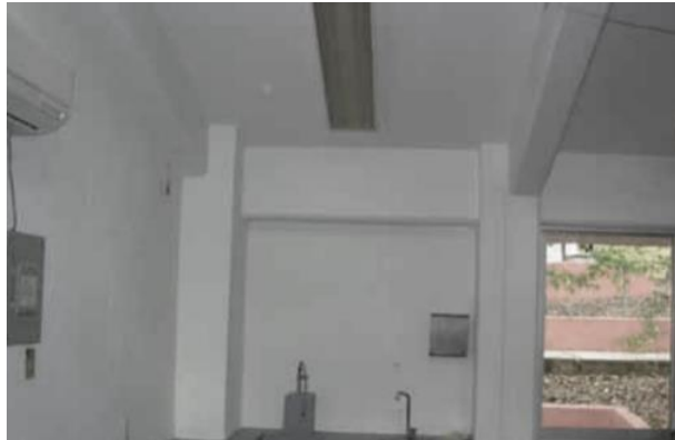
Fotografía 19, Marcos rígidos de instalaciones
