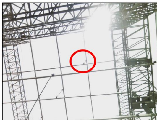
Figura 25. Ejemplo 3 Imagen luz visible de punto falla
