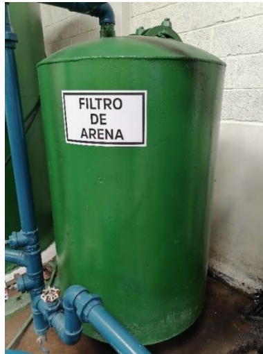
Figura 13. Filtro de arena
