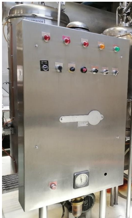
Figura 34. Caja de sistema eléctrico
