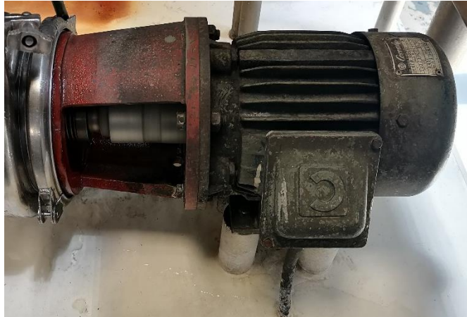
Figura 36. Bomba de agua
