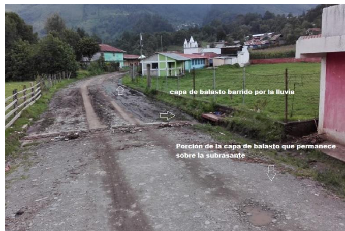
Figura 2. Efectos de la lluvia sobre la capa de balasto
