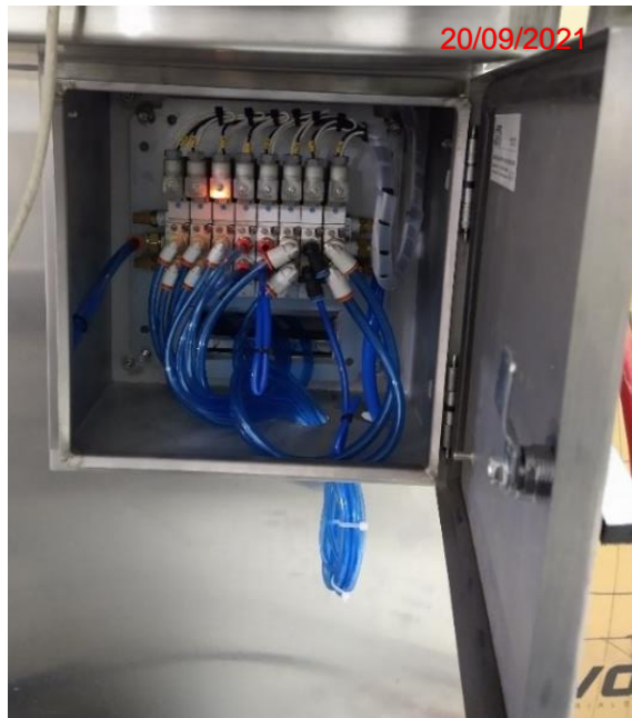
Figura 57. Panel de electroválvulas
