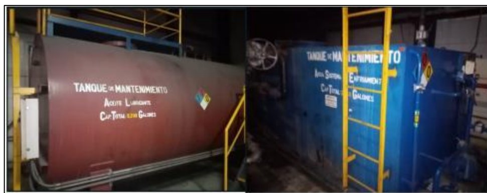
Figura 6. Tanque de aceite lubricante y agua para el cuarto de motores de la planta Las Palmas I
