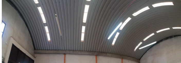
Figura 31. Luminarias Área de Administración
