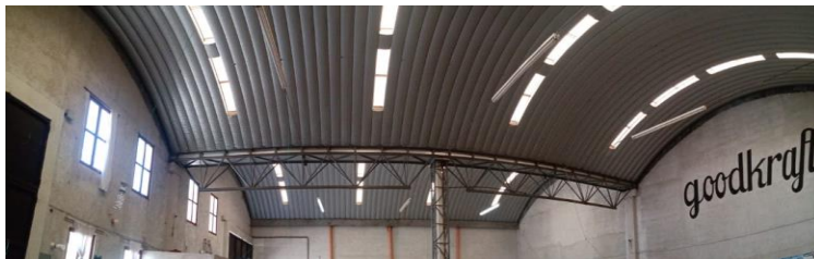
Figura 32. Luminarias Área de Producción
