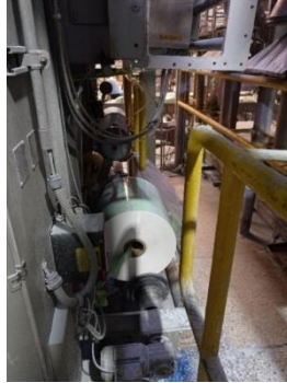
Figura 99. Desnivel entre las plataformas
