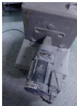
Figura 17. Motor eléctrico área de post adición
