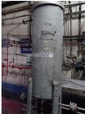
Figura 10. Tanque de perfume 1 área de post adición
