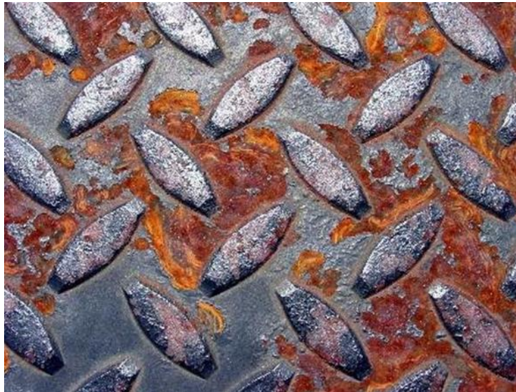
Figura 6. Corrosión en placas
