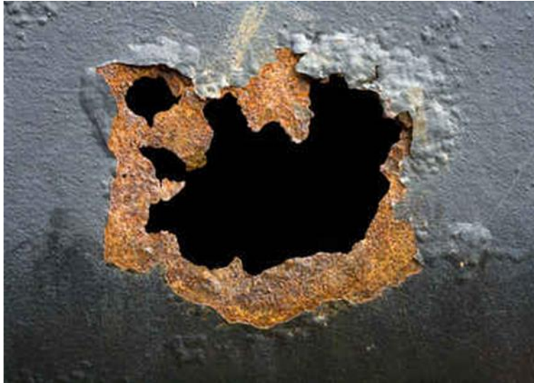
Figura 7. Corrosión por picado
