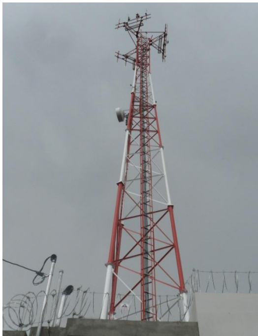
Figura 2. Estructura autoportada tipo triangular
