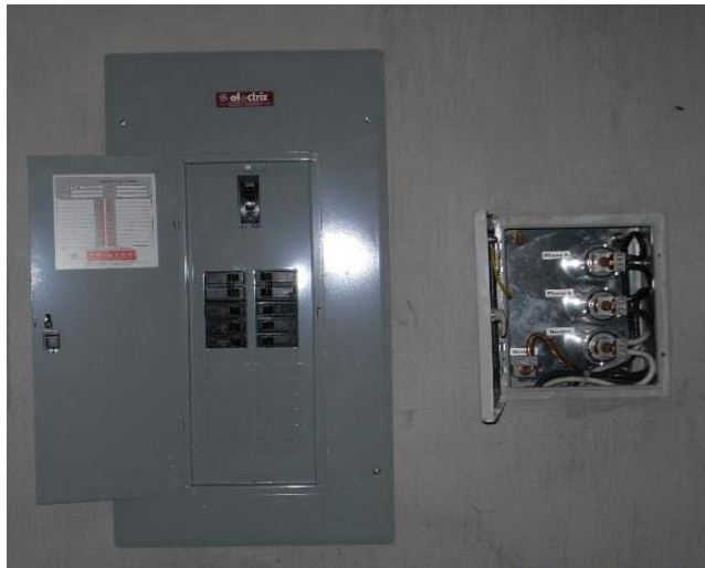
Figura 33. Tablero de distribución principal y supresor de transientes
