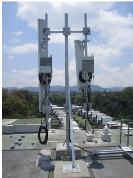
Figura 6. Acero utilizado en soportes de antenas
