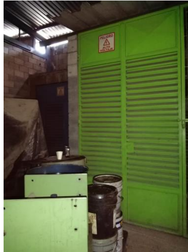
Figura 28. Obstaculización de entrada a generadores eléctricos
