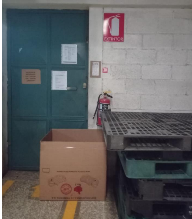
Figura 26. Obstaculización de extintores
