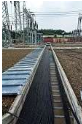
Figura 5. Cableado en las subestaciones
