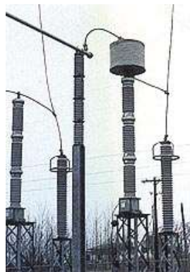
Figura 12. Trampa de onda sobre transformadores de tensión
