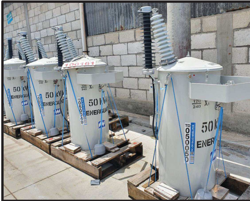
Figura 2. Transformadores de distribución tipo poste
