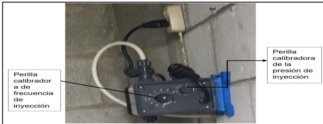
Figura 17. Bomba dosificadora de diafragma
