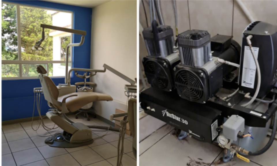
Unidad dental en la que se trabajó durante el EPS y compresor dental.
