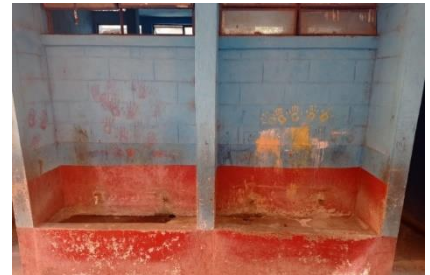
Imagen 1.8 Fotografía Inicial de Dania Cruz (Oratorio, Santa Rosa 2022). Archivos de Ejercicio Profesional Supervisado en San José Las Cabezas, Oratorio, Santa Rosa. Nota: Área de lavado de manos al igual que el resto del baño se observa sucia por el uso y la falta de mantenimiento de pintura.
