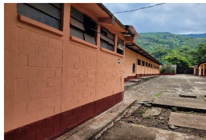
Imagen 1.19 Fotografía final de Dania Crúz (Oratorio, Santa Rosa 2022). Archivos de Ejercicio Profesional Supervisado en San José Las Cabezas, Oratorio, Santa Rosa. Nota: Observamos que el trabajo de pintura en la escuela ya se ve terminado, los baños se pintaron del mismo color que el resto de los salones.
