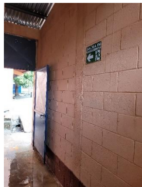
Imagen 1.29 Fotografía final de Dania Crúz (Oratorio, Santa Rosa 2022). Archivos de Ejercicio Profesional Supervisado en San José Las Cabezas, Oratorio, Santa Rosa. Nota: Proyecto Comunitario terminado.
