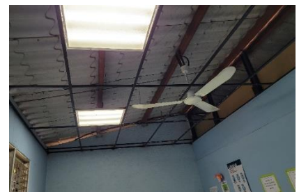
Imagen 1.36 de Dania Cruz (Oratorio, Santa Rosa 2022). Archivos de Ejercicio Profesional Supervisado en Clínica Municipal San José Las Cabezas, Oratorio, Santa Rosa. Nota: Desmontaje del cielo falso, la estructura metálica se observa en buen estado.
