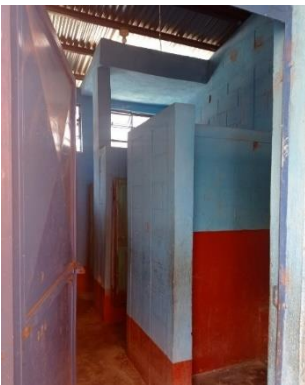
Imagen 1.9 Fotografía inicial de Dania Cruz (Oratorio, Santa Rosa 2022). Archivos de Ejercicio Profesional Supervisado en San José Las Cabezas, Oratorio, Santa Rosa. Nota: El interior de los baños se observan lo deteriorado de la pintura.
