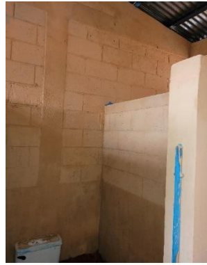
Imagen 1.22 Fotografía final de Dania Crúz (Oratorio, Santa Rosa 2022). Archivos de Ejercicio Profesional Supervisado en San José Las Cabezas, Oratorio, Santa Rosa. Nota: Área interna de los baños mejorando el ambiente escolar a los niños.
