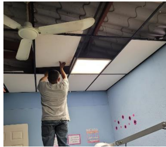
Imagen 1.38 de Dania Cruz (Oratorio, Santa Rosa 2022). Archivos de Ejercicio Profesional Supervisado en Clínica Municipal San José Las Cabezas, Oratorio, Santa Rosa. Nota: Montaje del nuevo cielo falso.
