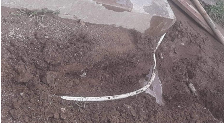
Foto 1: apertura del drenaje y los tubos que conducen el agua (tomada por Karen Wong)
