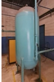
Figura 56. Depósito de aire comprimido húmedo
