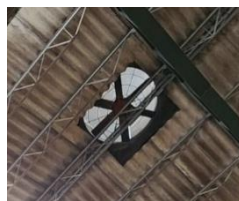
Figura 6. Extractores de aire del almacén de productos terminados
