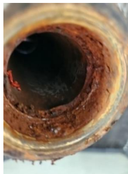
Figura 59. Corrosión interna en tubería principal del cuarto de compresores
