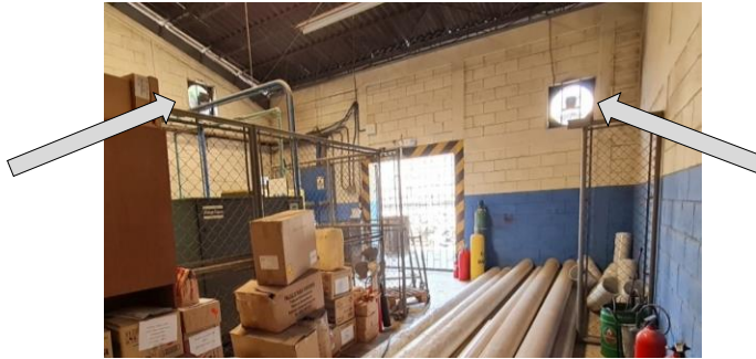
Figura 51. Sistema de ventilación actual del cuarto de compresores
