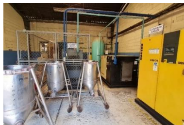
Figura 47. Vista frontal del cuarto de compresores
