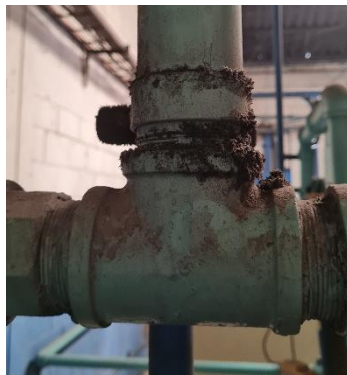
Figura 49. Tuberías de hierro sucias y con corrosión del cuarto de compresores
