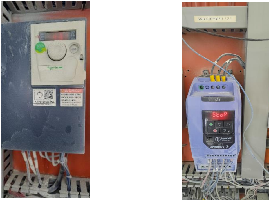
Variadores de velocidad del sistema antiguo
