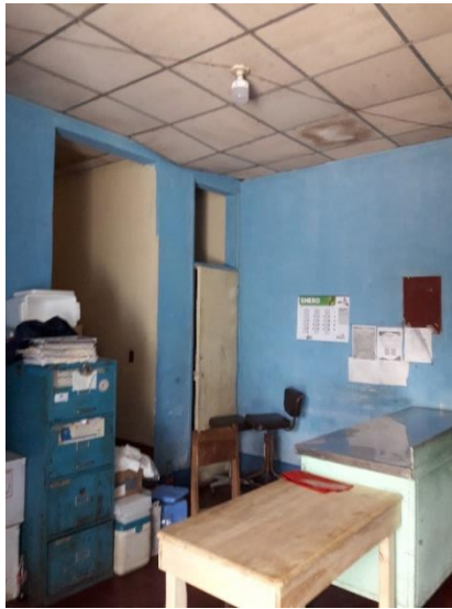
Fotografía 06. Vista del área de enfermería a los laterales se ubican el área de encamamiento de hombres y mujeres. Fotografía: propia (2022)
