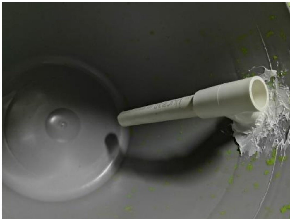
Figura 6. Instalación hidráulica dentro del bote No. 1
