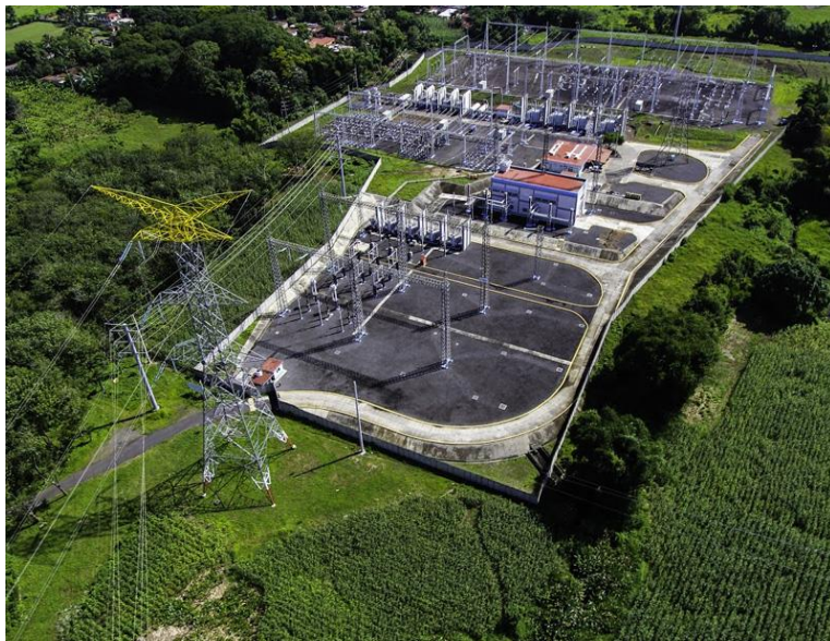
Figura 4. Subestación Los Brillantes
