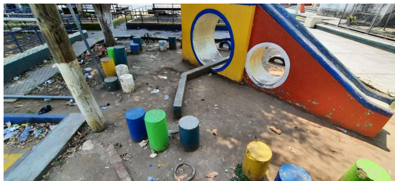
ILUSTRACIÓN 4 DETERIORO ACTUAL JUEGOS INFANTILES, FUENTE ELABORACIÓN PROPIA
