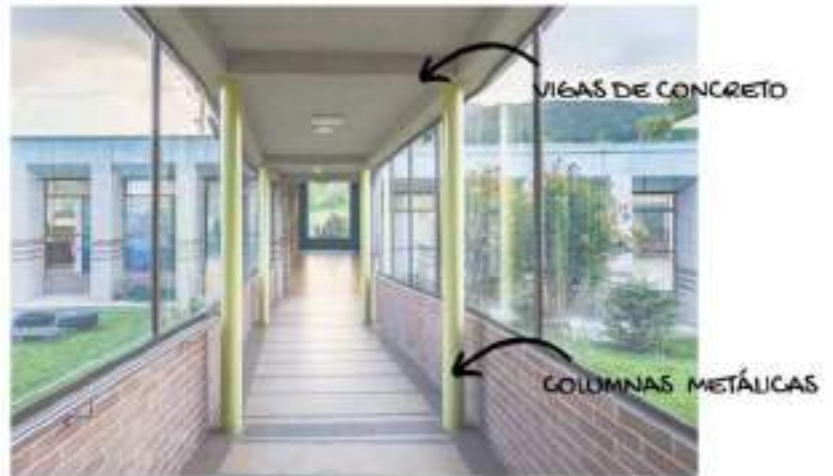
Figura 29, Análisis tecnológico-constructivo del Hogar para Abuelos Tocancipá. Elaboración propia basada en https://www.plataformaarquitectura.cl/cl/941578/hogar-del-abuelo-de-tocancipa-rizoma-arquitectos
