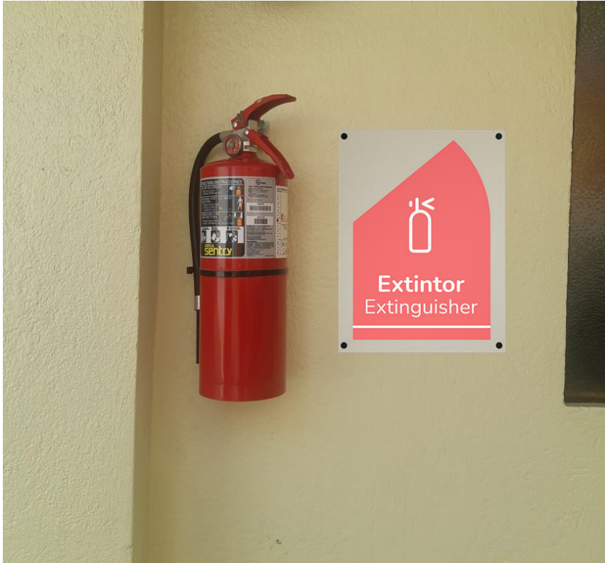
Fig. 76- Referencia visual e implementación de señal de emergencia de incendios, 2021.
