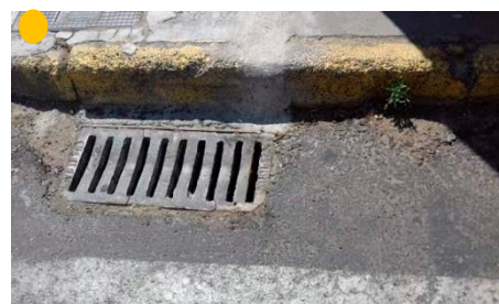
Figura 68 Alcantarillado Fuente: elaboración propia
