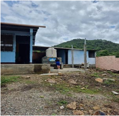
Estado inicial del área de lavado de Escuela Oficial Rural Mixta de aldea El Oratorio.
