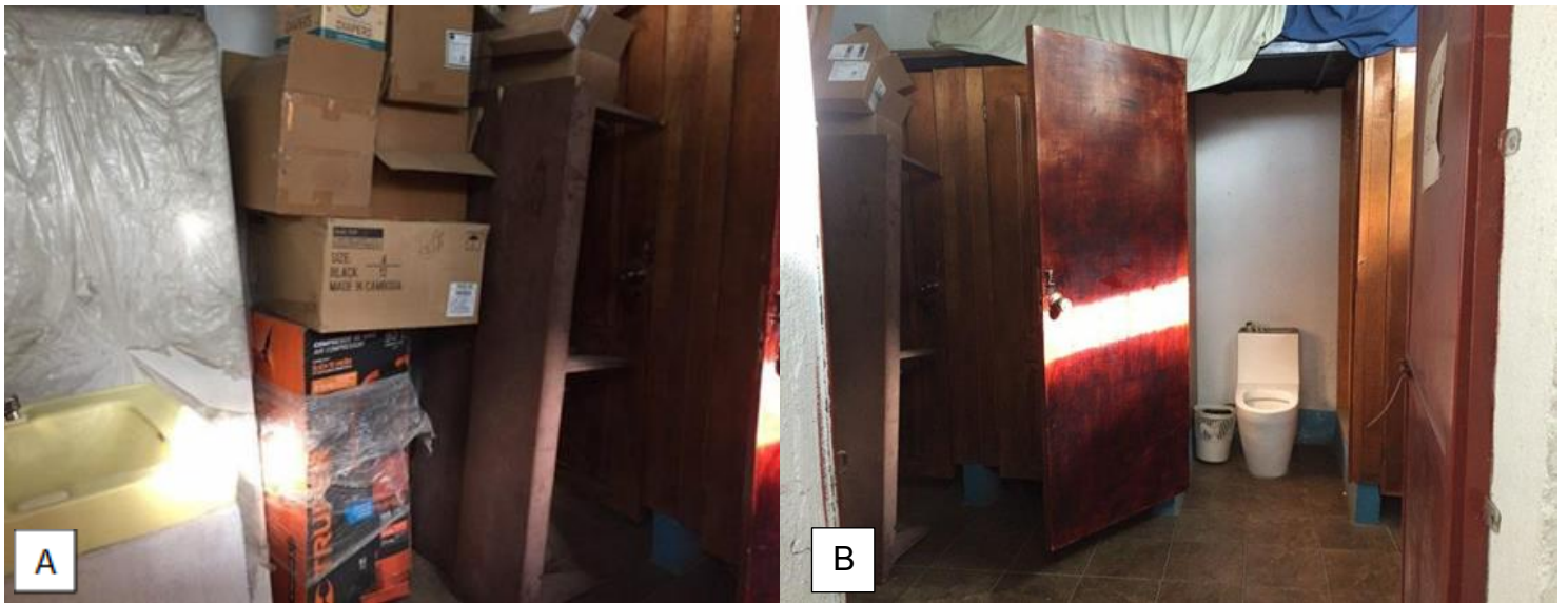
Figura No. 2: A= Baño inhabilitado; B= Único baño en uso, en condición deteriorada.
