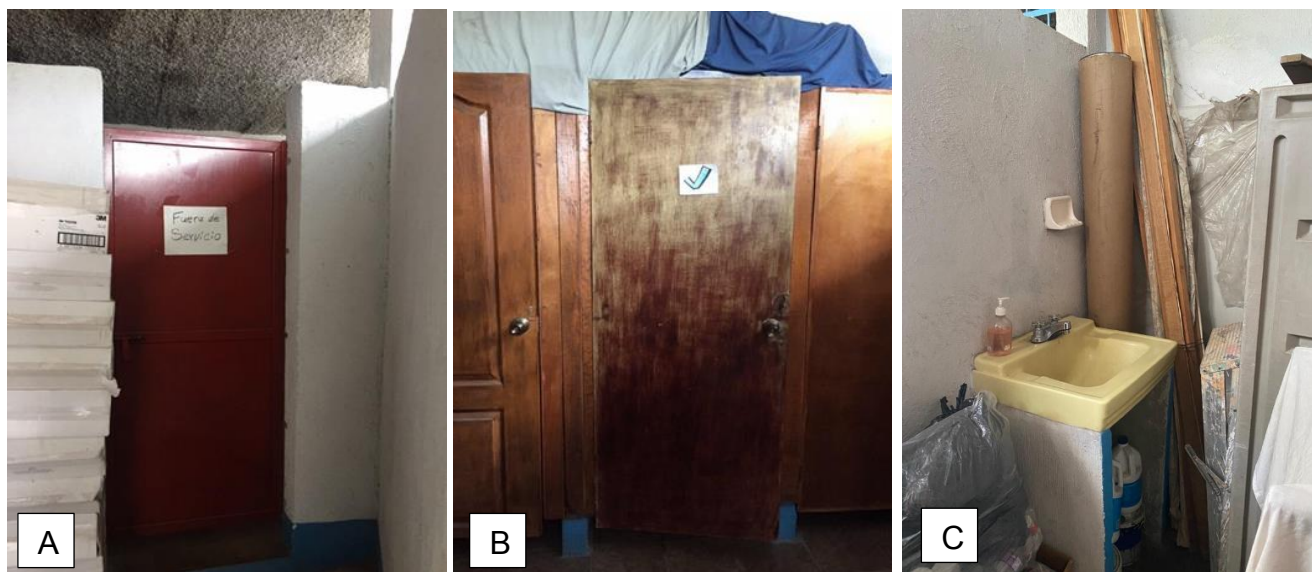
Figura No. 1: A= Baño fuera de servicio; B= Único baño en uso; C= Área utilizada como bodega.
