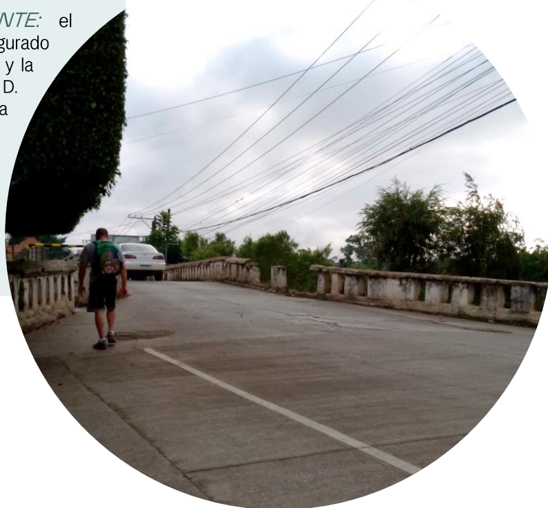
Figura 105. Vista del Puente San Vicente actualmente, con nulo mantenimiento y severo deterioro.
