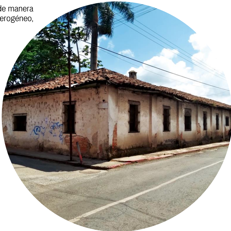
Figura 151. Inmueble en la 2a calle 8-22, zona 2, edificio de categoría C, según la Nómina. Se encuentra actualmente deshabitado y deteriorado.
