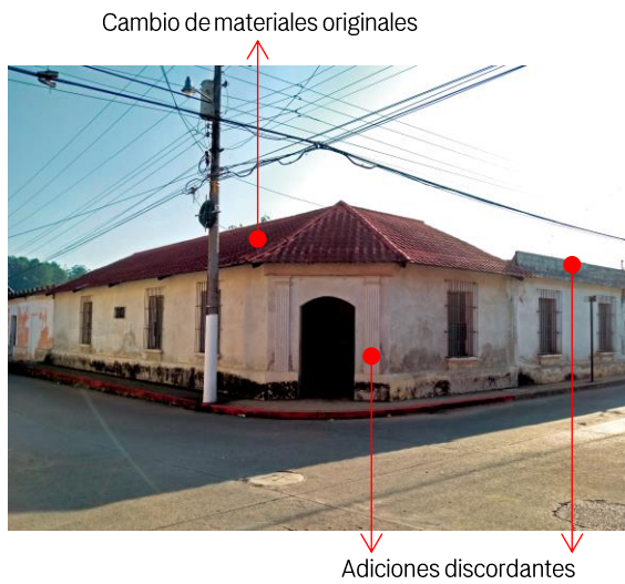
Figura 156. Daños y alteraciones, inmueble esquina 3ª calle 6ª avenida, zona 4. Fuente: Elaboración propia, estudio de campo mayo 2021
