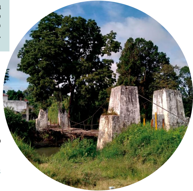
Figura 106. Vista del Puente Chichún actualmente. Fuente: Elaboración propia, estudio de campo mayo 2021.
