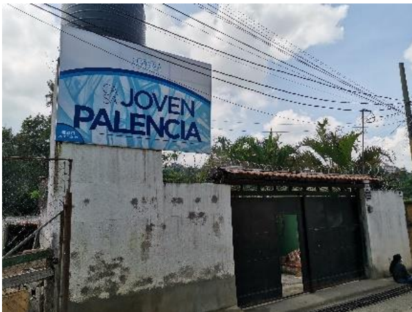
Imagen 9. Se observa la fachada frontal de Casa Joven Palencia. Fuente: Archivo Secretaría de Bienestar Social
