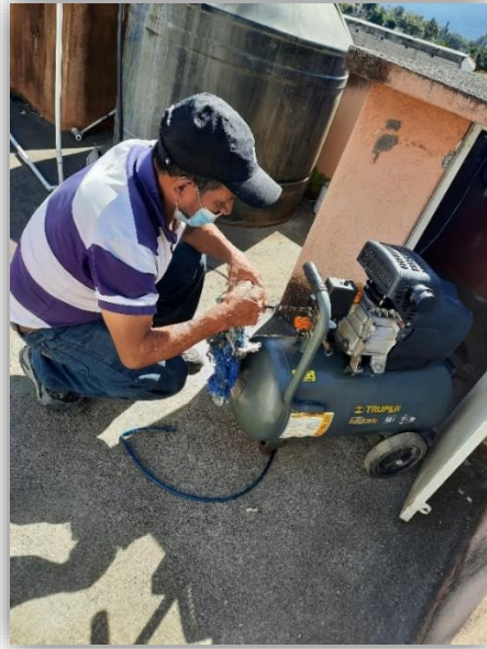
Imagen 38. Técnico realizó servicio y revisión del funcionamiento del compresor dental.
