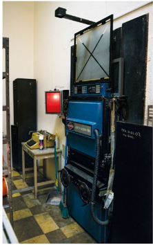
Parte externa de la máquina ubicada en la entrada del cuarto.
