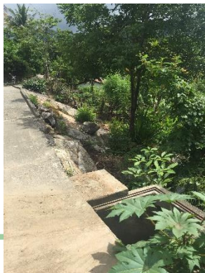
Figura 122. Drenaje sanitario. Fuente: Fotografía propia
