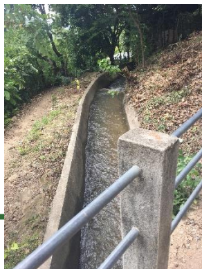
Figura 123. Drenajes pluviales Fuente: Fotografía propia
