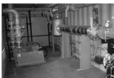
Sala de desgasificación
