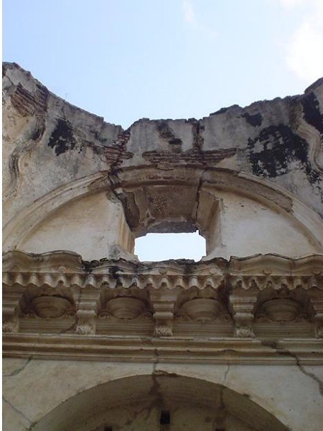
La fotografía muestra fallas en arcos y pechinas.
