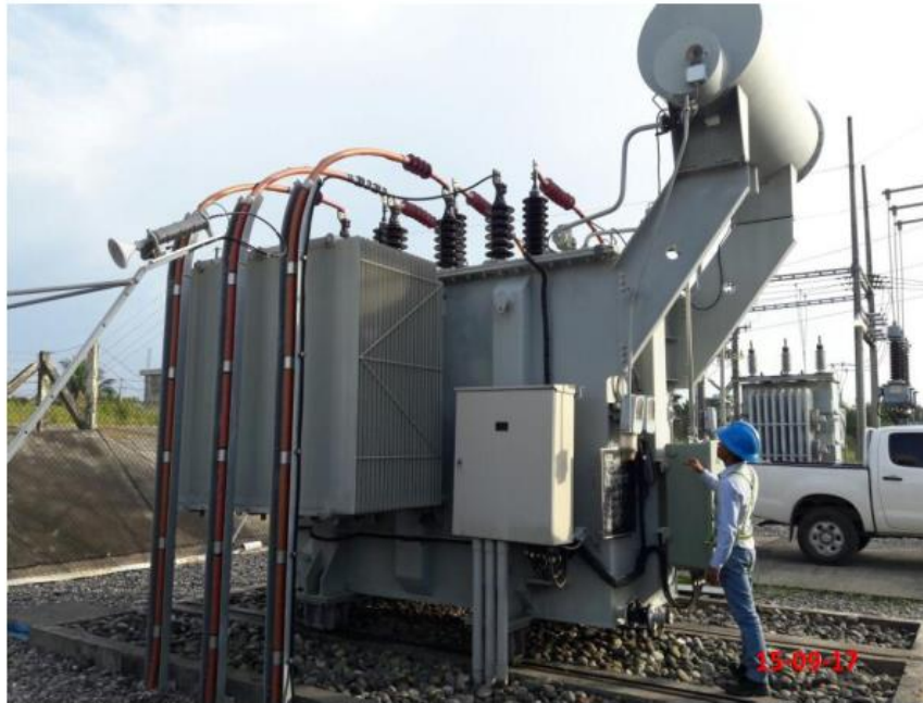
Figura 6. Revisión y extracción de información de relés de protección, transformador 69/34.5 kV, subestación Playa Grande
