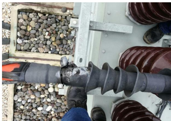
Figura 7. Mufa dañada del transformador 69/34.5 kV subestación Sayaxché, Petén
