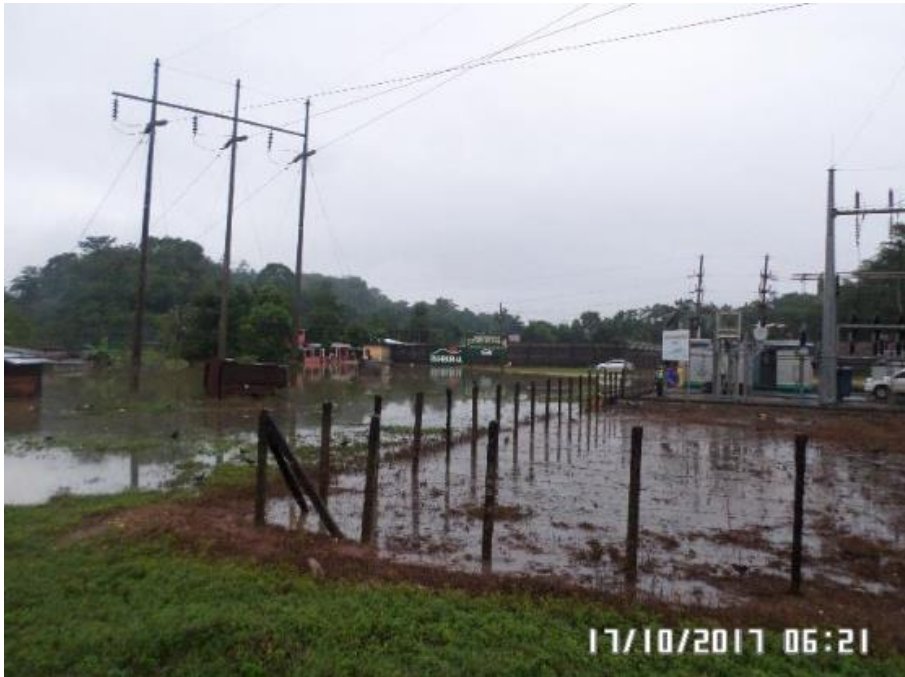
Figura 8. Inundación de una subestación desborde del río San Simón, Alta Verapaz
