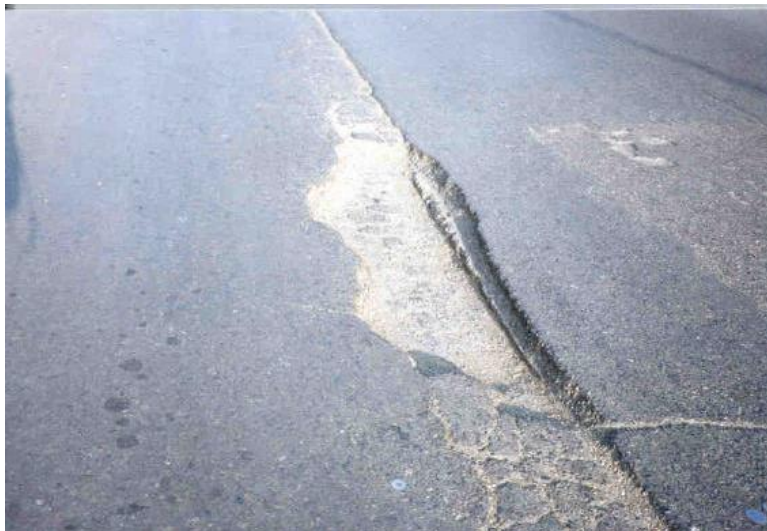
Figura 15. Severidad alta de grietas por reflexión de juntas con bache
