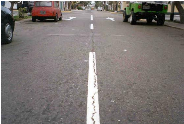
Figura 2. Severidad media de agrietamiento longitudinal
