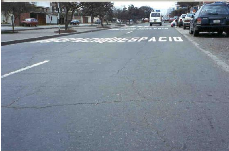
Figura 10. Severidad baja de agrietamiento en bloque
