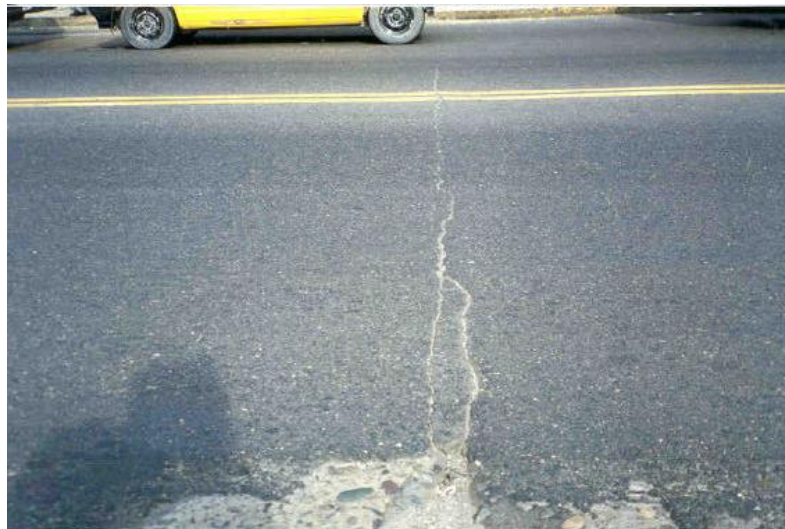
Figura 4. Severidad baja de agrietamiento transversal
