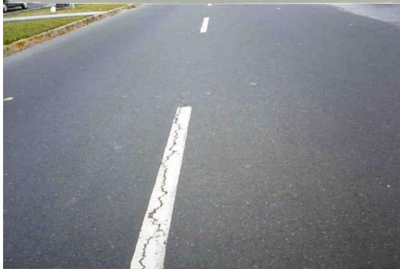
Figura 1. Severidad baja de agrietamiento longitudinal
