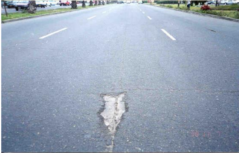
Figura 14. Severidad media y alta de grietas por reflexión de juntas
