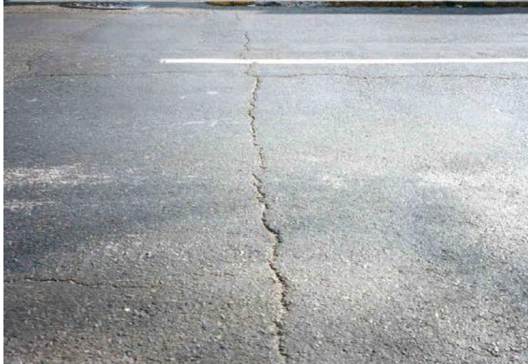
Figura 5. Severidad media de agrietamiento transversal
