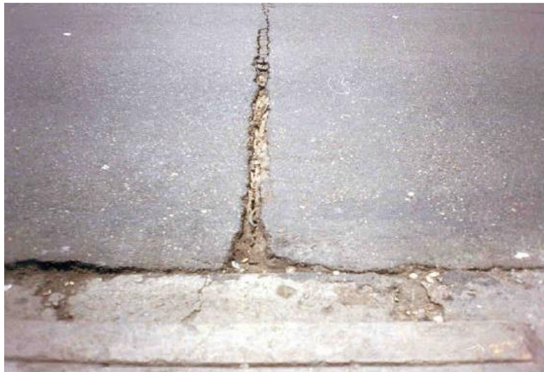
Figura 6. Severidad alta de agrietamiento transversal
