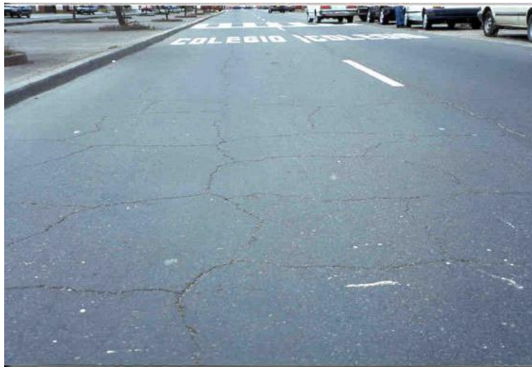
Figura 11. Severidad media de agrietamiento en bloque
