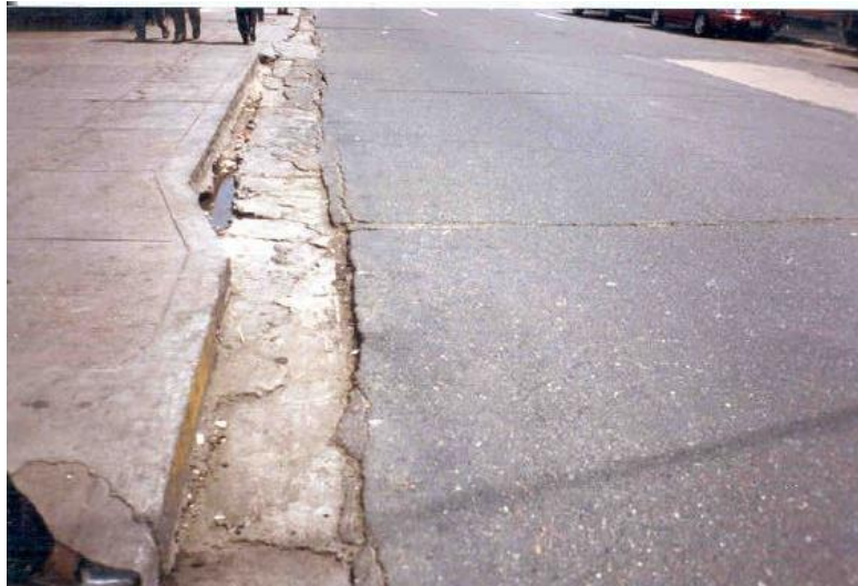
Figura 9. Severidad alta de agrietamiento de borde
