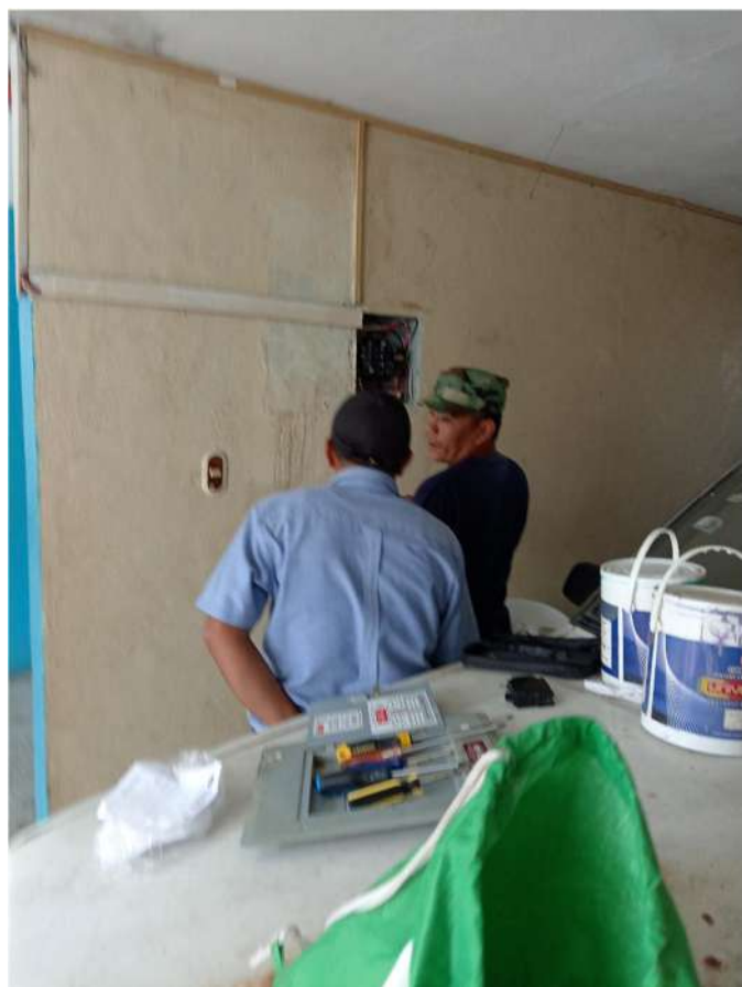
Figura 87. Cambio de flipones de la caja central.
