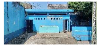
Imagen 1.6 de Mario García (Malacatán, San Marcos 2023). Archivos de Ejercicio Profesional Supervisado en Malacatán, San Marcos. Nota: Se observa la fachada de los baños con la pintura deteriorada.
