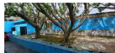
Imagen 1.3 de Mario García (Malacatán, San Marcos 2023). Archivos de Ejercicio Profesional Supervisado en Malacatán, San Marcos. Nota: Se observa el repello del socalo de la pared perimetral y árboles sin pintar.
