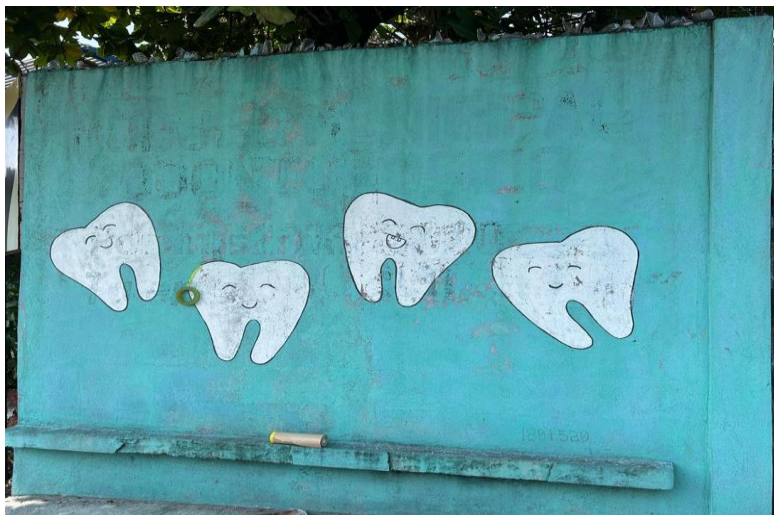
Foto 5. Estado inicial de Módulo Odontológico de San Sebastián, donde se evidencia deterioro de paredes.
