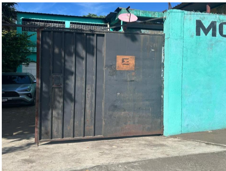
Foto 6. Estado inicial de Módulo Odontológico de San Sebastián, donde se evidencia deterioro del portón.
