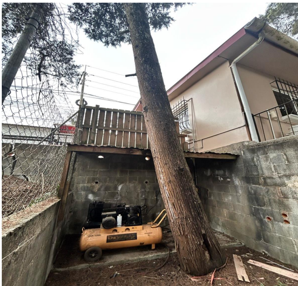
Imagen 29: En el exterior se encuentra el compresor, es industrial, pero ha funcionado bien, se cambi 1 en julio del a o pasado.
