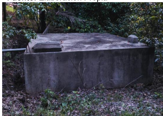
Figura 105 Tanque de agua, (Kevin Rodríguez, 2024)
