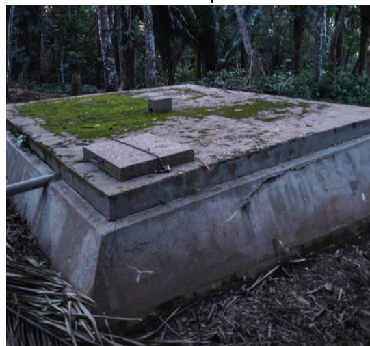
Figura 87 Tanque de almacenamiento, (Kevin Rodríguez, 2024)
