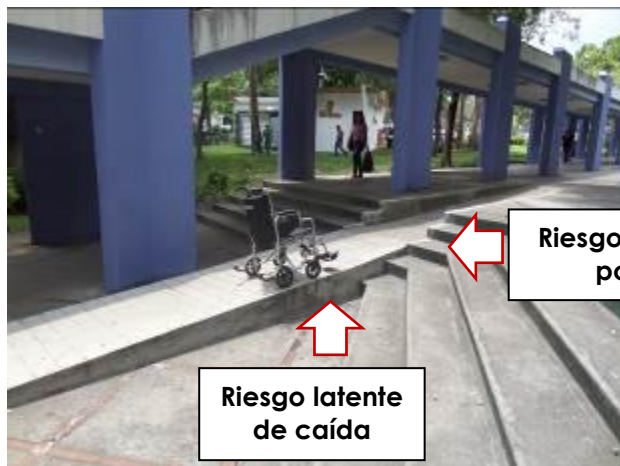
Capítulo 6 imagen 40 Rampa sumamente peligrosa
