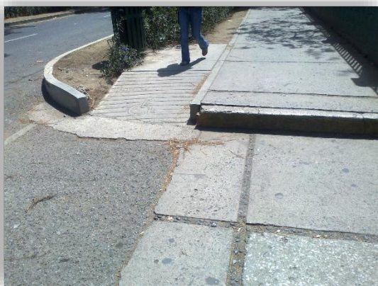
Capítulo 6 imagen 16 Imagen de rampas en condiciones de paso mínimas
