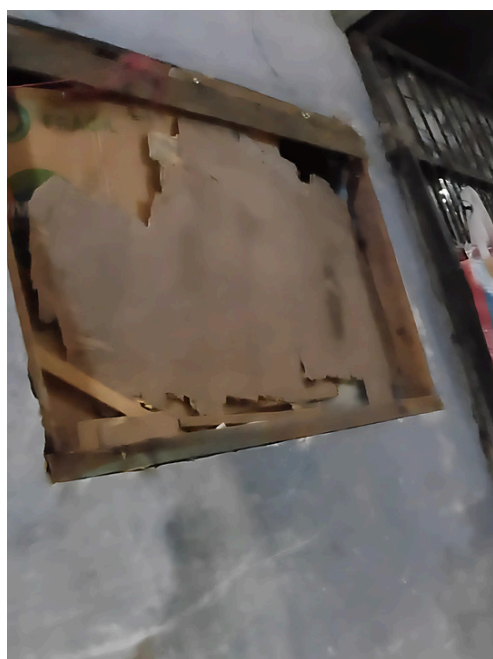
Figura No. 1. Fotografía de infraestructura deteriorada Fuente: elaboración propia
