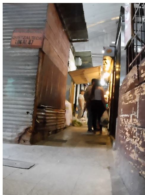
Figura No. 2. Fotografía de infraestructura deteriorada Fuente: elaboración propia
