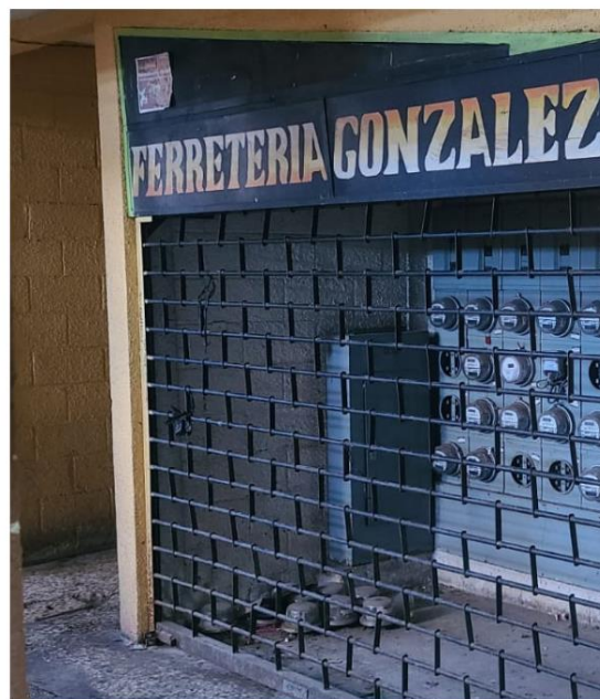
Imagen 9: Fotografía contadores de energía eléctrica
