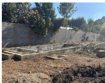
Figura 72. Planta de tratamiento
