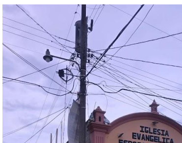
Figura 68. Poste de iluminación
