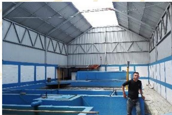
Figura 65. Fotografía. Interior de planta de tratamiento, Mercado Concepción Fuente: Googlemaps
