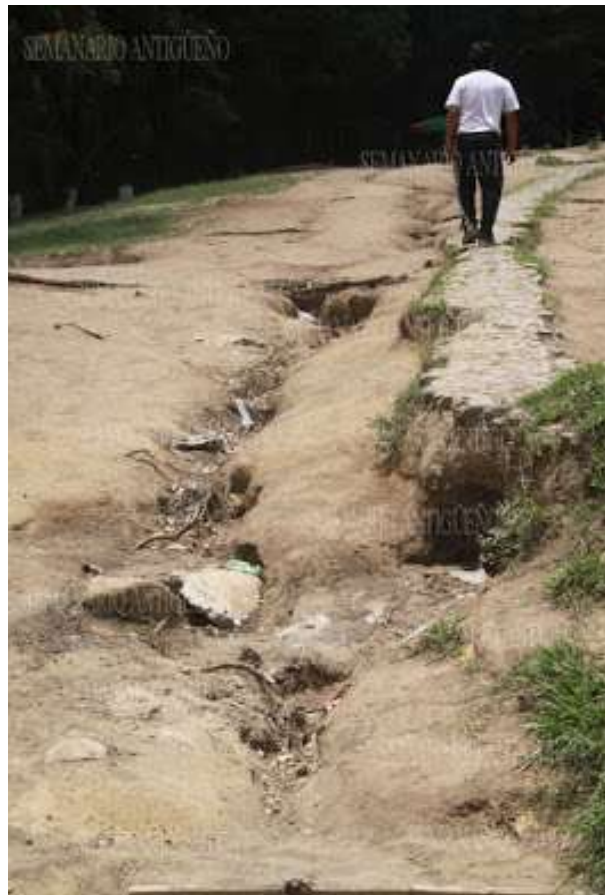
Fotografía No. 8: Vista del área del mirador de la cruz en donde se evidencia la erosión del suelo y la pendiente en donde los visitantes caminan.
