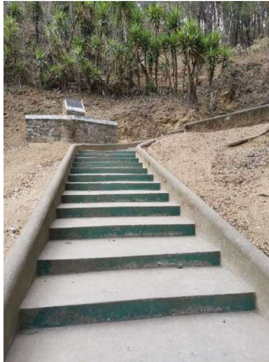
Fotografía No. 4: Tramo inicial del recorrido del acceso actual. No existe más que el sendero y gradas en concreto. No hay ningún tratamiento de suelos, lo que provoca una constante erosión de los mismos.
