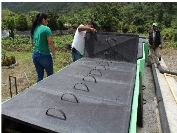
Figura 164. Caja de rejillas
