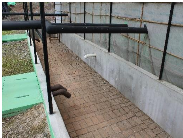
Figura 167. Patio de lodos
