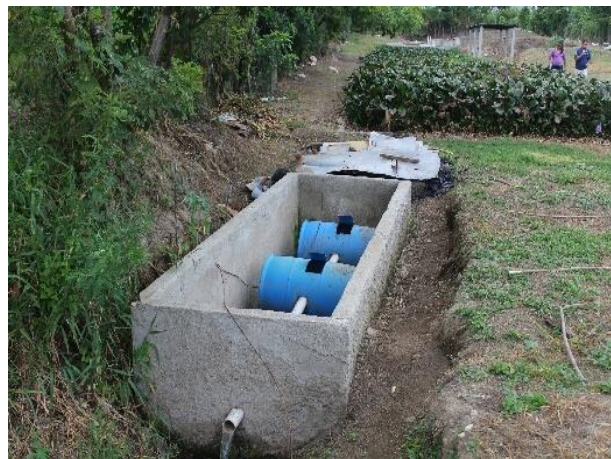
Figura 156. Filtros y salida
