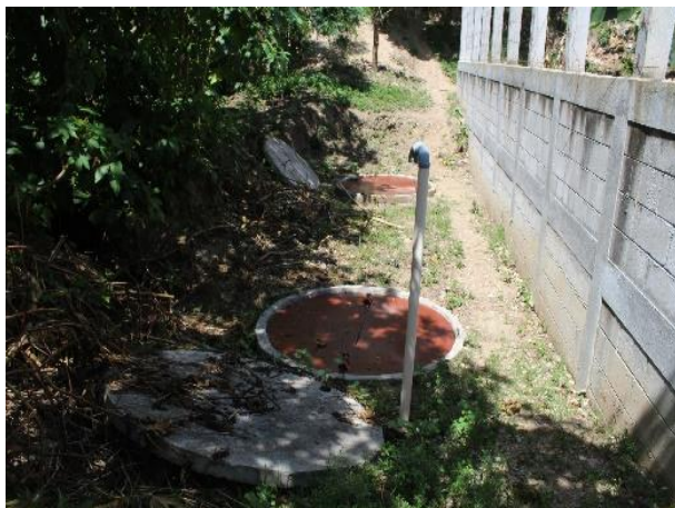
Figura 116. Pozo de absorción
