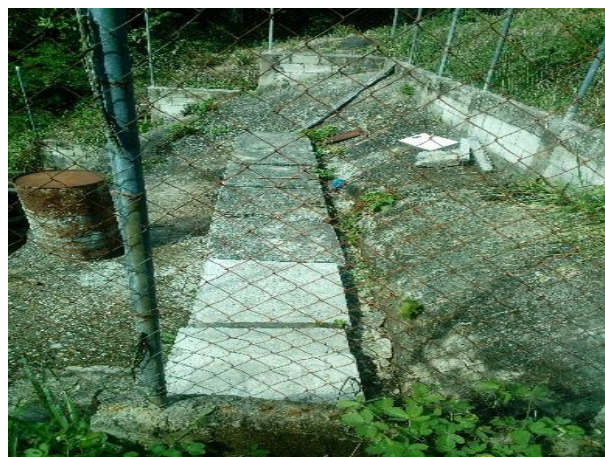
Figura 143. Canal de rejillas y desarenador
