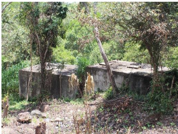
Figura 136. Fosas sépticas PTAR
