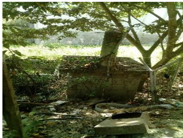
Figura 103. Caseta para controles eléctricos.
