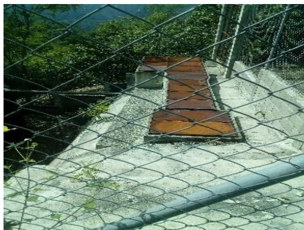
Figura 145. Canal de rejillas y desarenador
