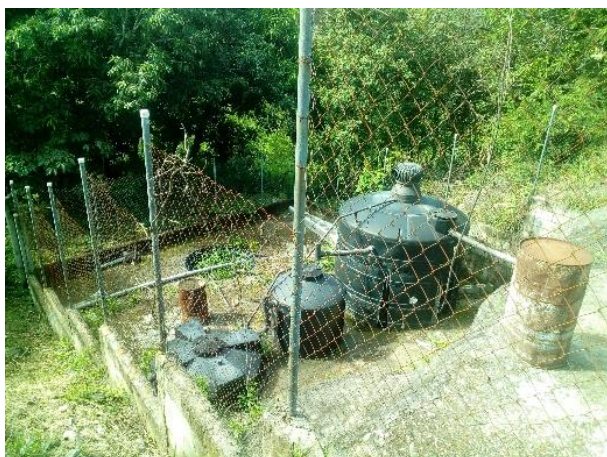
Figura 142. Tratamiento primario y secundario
