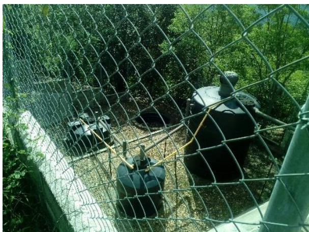
Figura 144. Reactor, filtro y sedimentador
