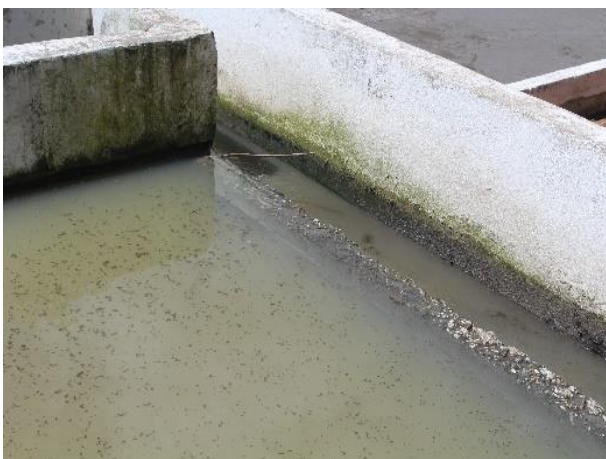
Figura 114. Rebalse en los tanques
