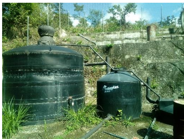
Figura 141. Estado de los tanques para tratamiento.
