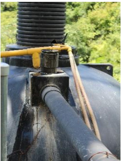
Figura 129. Reactor anaeróbico de flujo ascendente colapsado
