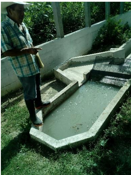
Figura 110. Entrada del afluente PTAR
