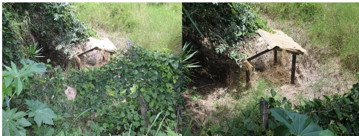
Figura 120. PTAR no terminada, foco de contaminación.
