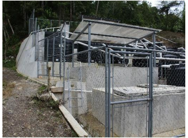
Figura 174. Canal de rejas y patio de lodos
