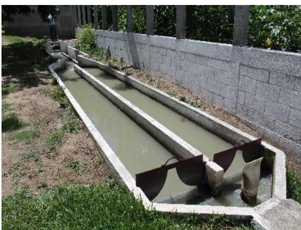
Figura 112. Vertedero de Demasías
