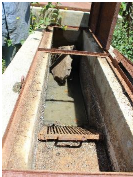
Figura 128. Entrada efluente y canal de rejillas
