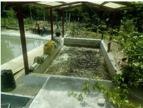
Figura 107. Patio de lodos
