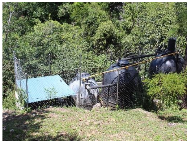
Figura 132. Vista frontal PTAR
