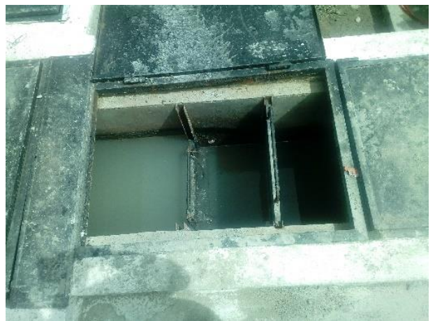
Figura 106. Canal de rejás (Pretratamiento)
