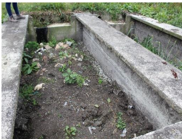
Figura 101. Patio de lodos
