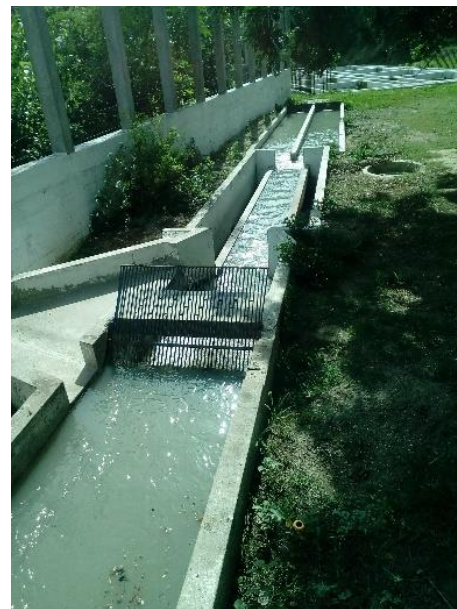
Figura 111. Canal de rejás
