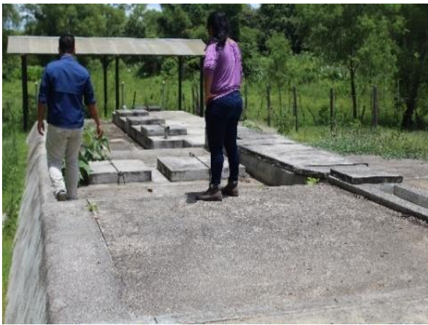
Figura 148. Caja de rejas y desarenador
