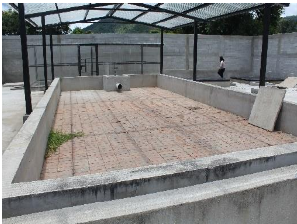
Figura 123. patio de lodos
