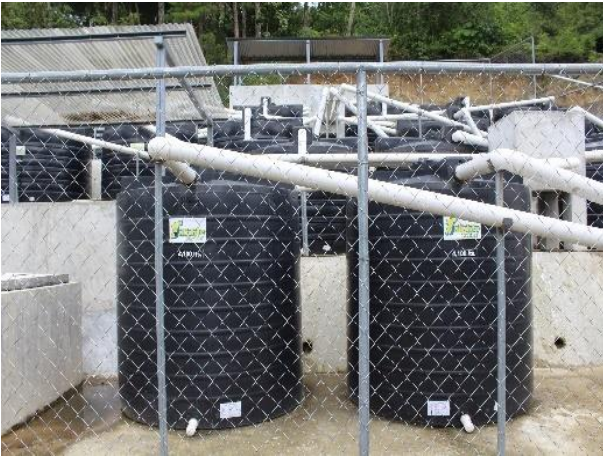
Figura 173. Parte frontal de PTAR
