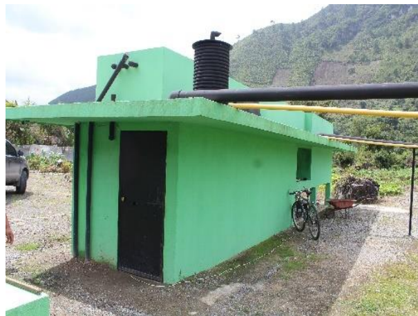
Figura 163. Estación sistema de bombeo
