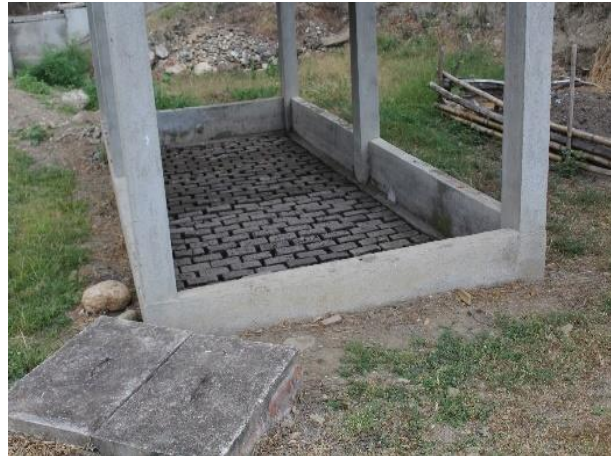
Figura 154. Patio de lodos
