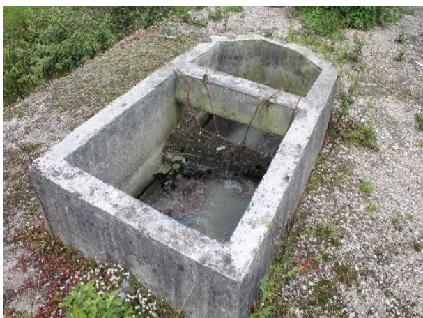
Figura 98. Canal de rejás en mal estado
