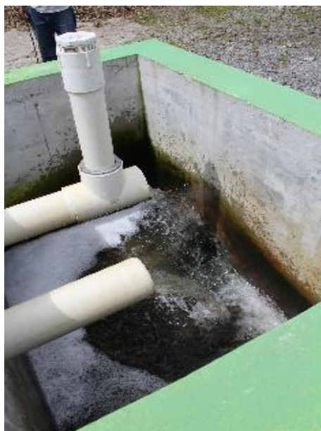
Figura 172. Dosificador de cloro
