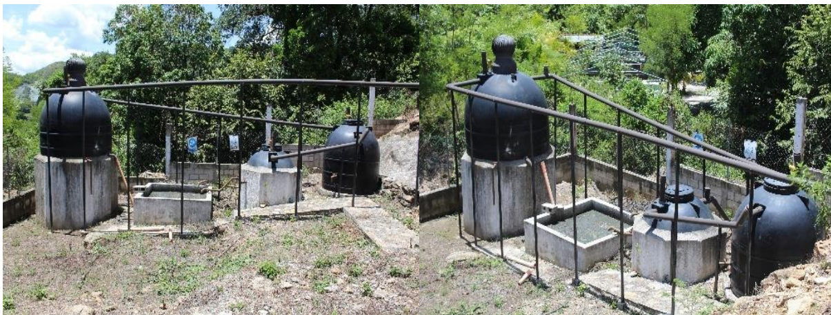
Figura 133. Vista del reactor, filtro y sedimentador para el tratamiento primario y secundario.
