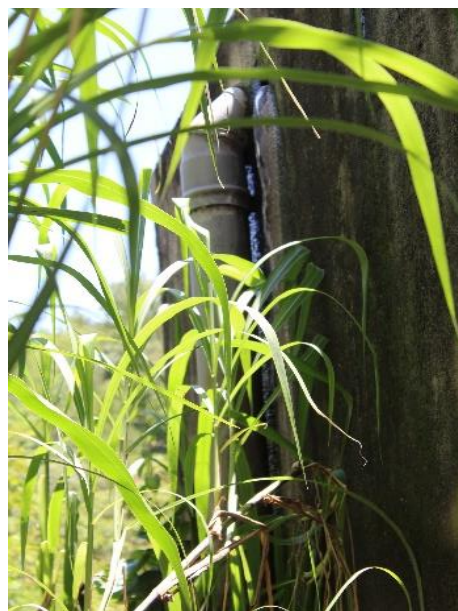
Figura 138. Tubos que conectan las fosas sépticas
