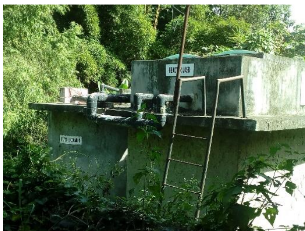
Figura 104. Tratamiento primario y secundario
