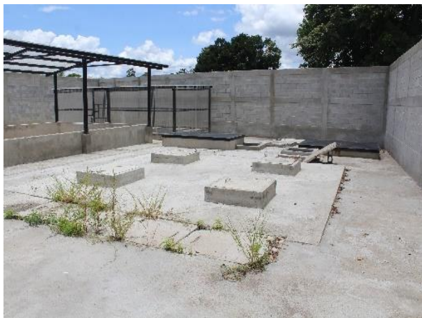
Figura 121. Filtros y sedimentador
