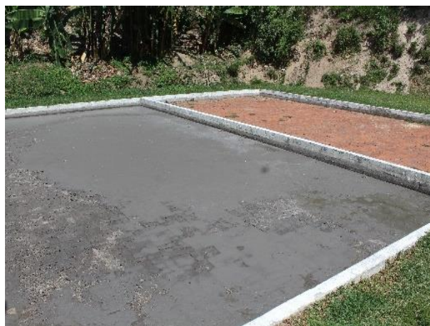
Figura 115. Lechos de secado de lodos
