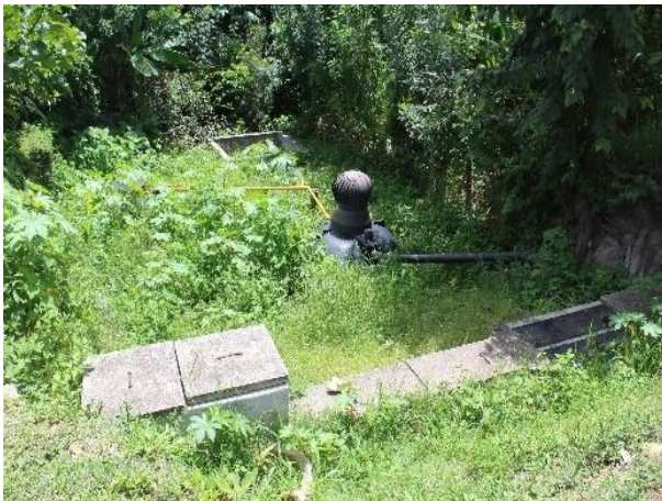
Figura 118. Vista frontal PTAR
